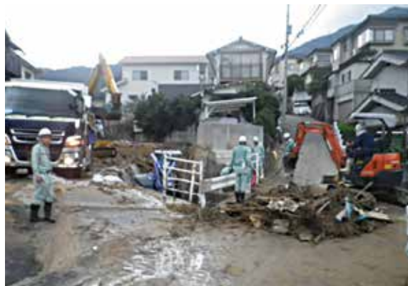
可部東地区土砂撤去状況
