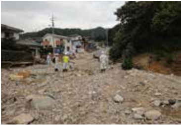
施工前 土砂、流木が堆積し道路を水みちとして水が流れている。
