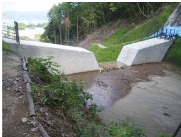
土石流発生直後
